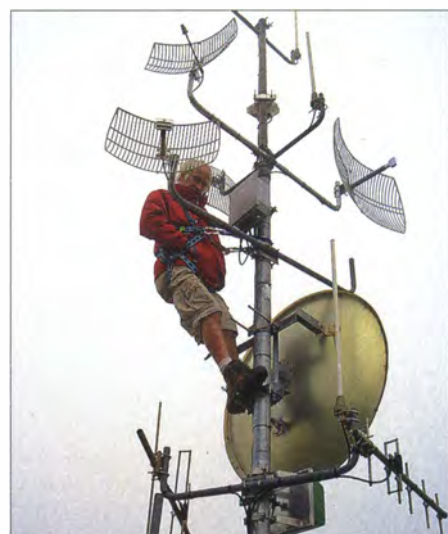
Bild 3: Toni, IN3ZMB, an der Antennenanlage des Rittner Horn (2260 m); im Spätsommer 2014 wurde die gesamte Technik auf den neuen Funkmast verlegt.
